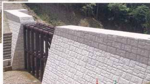
← 正面 (下流) 露出部 割石40 (1・2・4) ↓ 背面 (上流) 全面、埋設部 フラット 使用
