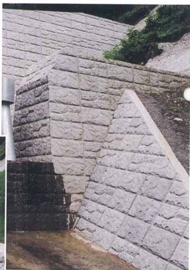
兵庫県豊岡土木事務所・但東事業所 発注 久畑宮ノ奥川通常砂防工事 割石40(1・2・4)タイプ
